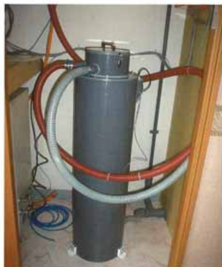
8. 機械室の集中タンク
