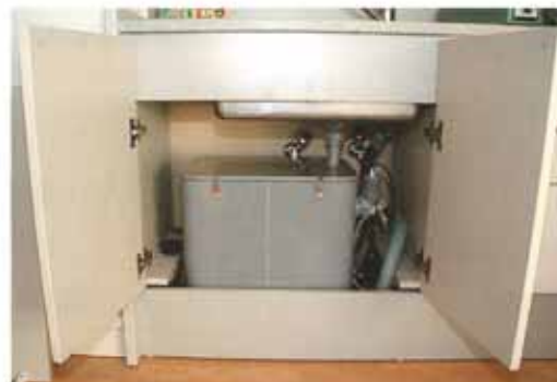
7. シンク下のタンク
