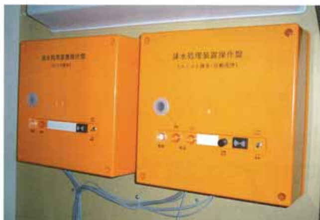
9. 安全警報装置
